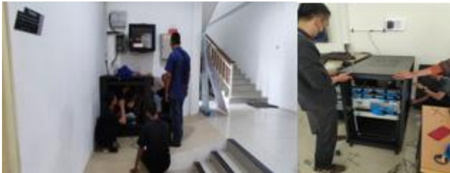
Gambar 3.46. Upgrade dan Relokasi PABX Sumber: Diskominfo DIY, 2023
