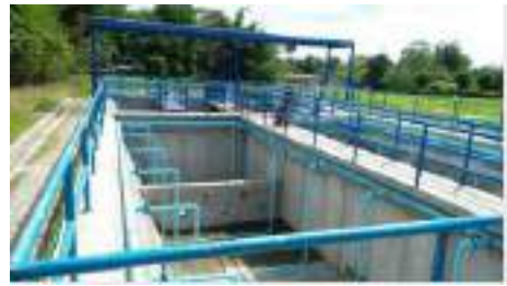
Unit bak aerasi
