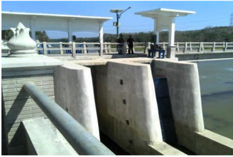
Gambar 6.21. Pintu Intake Kamijoro
